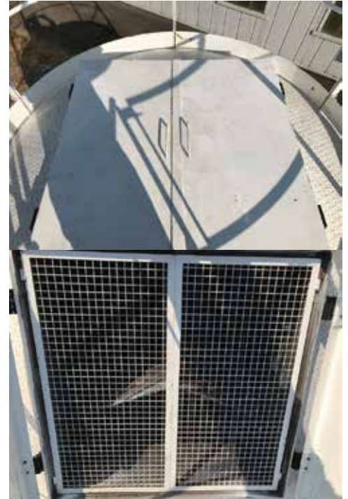
Reja de Seguridad cercana a la puerta superior / Puertas de cierre
